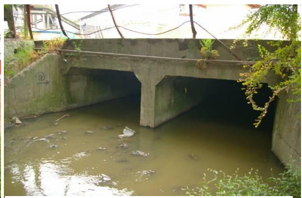
Figura 35 R-ul Valea Trandafirilor la ieșire din captarea subterană
