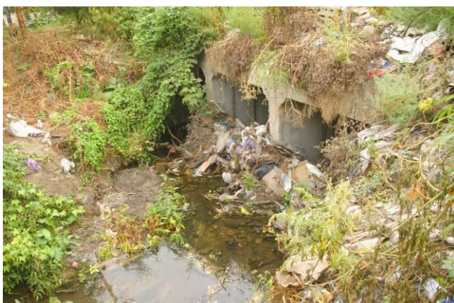
Figura 30 R-ul Malina Mică la intrare sub str. Calea Moșilor
